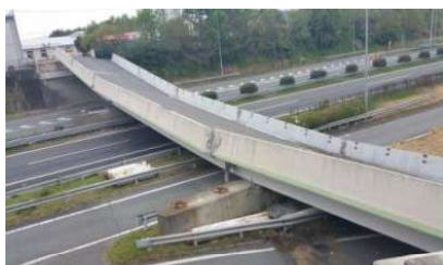
<緊急輸送道路上の橋梁の崩落>
